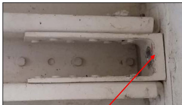
Zona donde aparecieron las indicaciones de fisura
